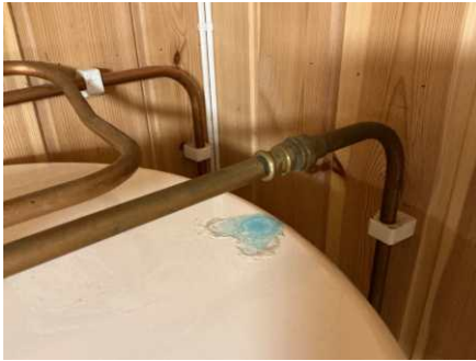
Korrosjon og avdrypp.
