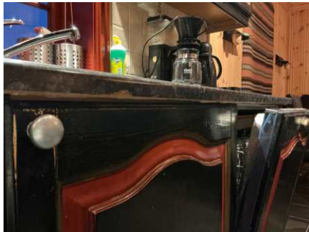
Skader og svellinger i kjøkkenbenken.
