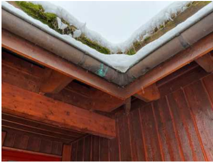
Korrosjon på takrenner.
