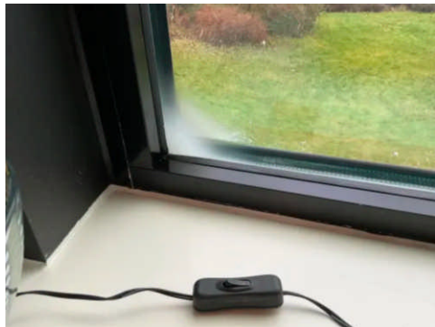
Misfarging i hjørne av glass.
