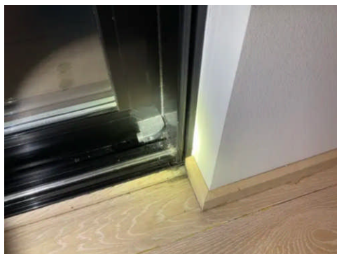
Fukt i hjørne av skyvedør 3. etasje
