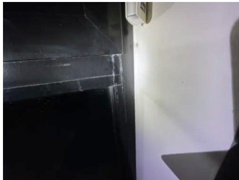
Renninger på vindu 3. etasje
