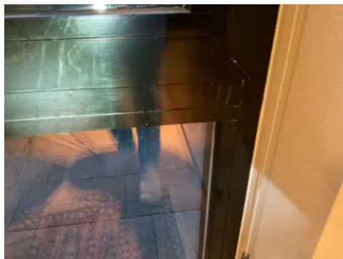
Renninger/fukt på vindu i 3. etasje
