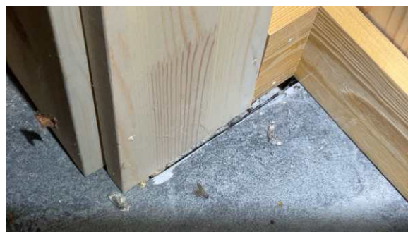
Bildet viser at det ikke er tettesjikt og oppkant langs yttervegger.
