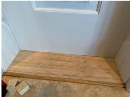
Tett ved dør for tilluft.
