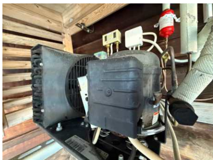
Aggregat til kjølerom.
