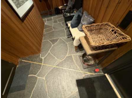
Gulvavvik ved entre.
