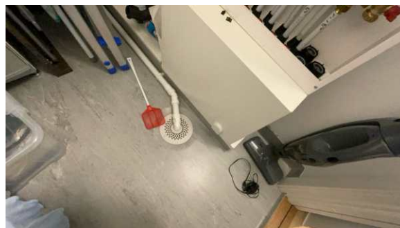
Eventuelt lekkasjevann ledes mot sluk på teknisk rom.
