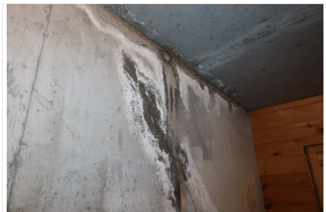
Fukt/saltutslag på vegg i boden.
