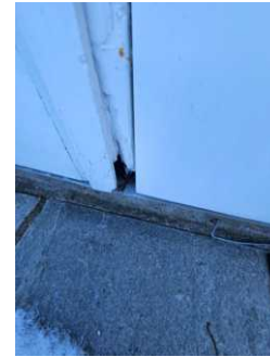
Råteskade i inngangsdør til soverom i 1. etasje.
