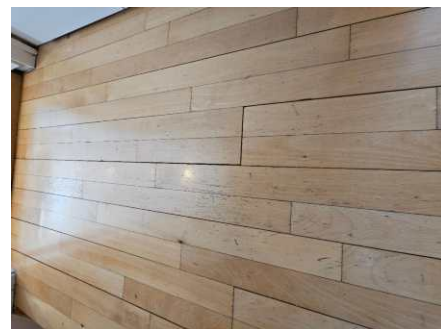
Sprekker mellom staver i heltregulv.
