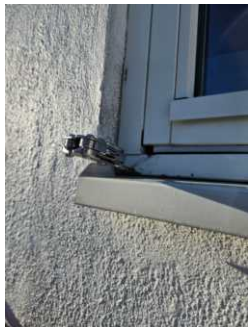
Påbegynnende råteskade i feilmontert vindu ved kjøkkenet.
