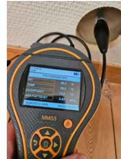
Måling av trefukt i utlekket veggkonstruksjon i stue under bakkenivå.
