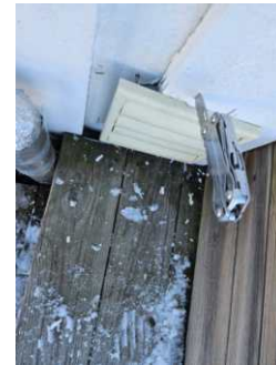
Råteskadet kledningsbord i 1. etasje.
