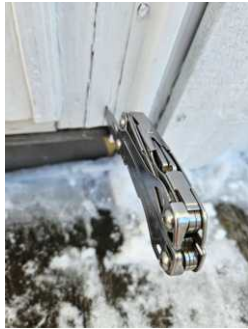
Råteskade i terrassedør i 2. etasje.
