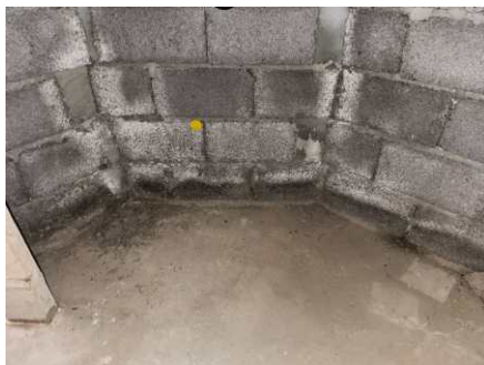
Innsiden av lecamur er misfarget
