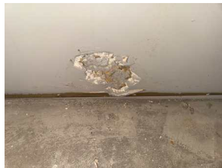
Skade på sandwich-element
