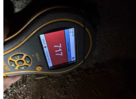
Fuktindikasjon nedre del av kjellervegg
