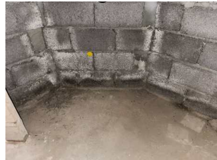
Saltutslag og misfarging på lecamur
