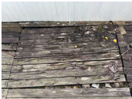
Sydøstvendt balkong har råteskade
