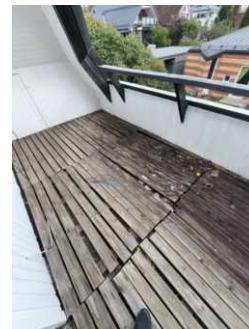
Sydøstvendt balkong har råteskade
