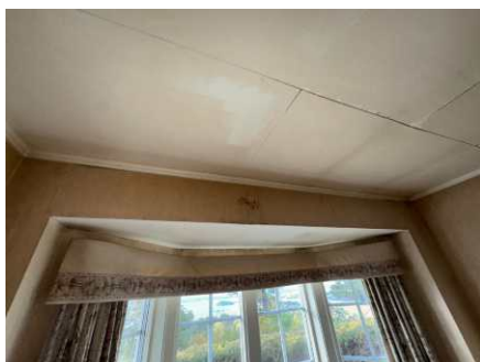
Skade på overflater i spisestue etter tidligere lekkasje fra taket
