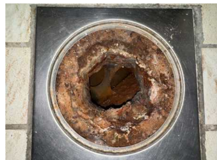
Soilsluk fra byggeår
