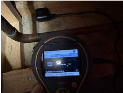
Fuktsøk med pigger i treverk i tilstøtende kott (bod)
