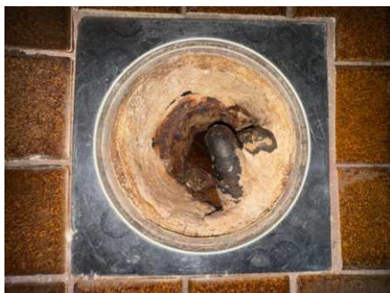
Soilsluk fra byggeår
