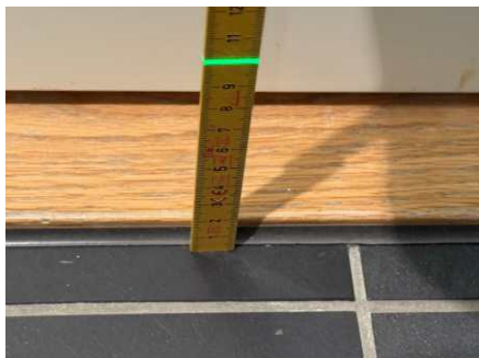
Fallforhold ca. 100 mm overkant gulv ved terskel
