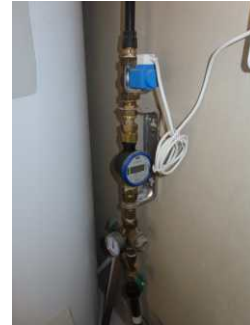
Vanninntaksledning med hovedstoppekran, vannmåler samt magnetventil tilknyttet føler i bla kjøkkenbenk.
