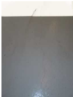
Påvist rissprekk/tørkesprekk i gulvet.
