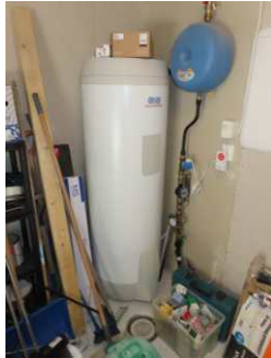
Varmtvannsbereder på teknisk rom.
