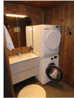
Del med vann og avløpsuttak for vaskemaskin. Servantskap med heøstøpt servantplate.
