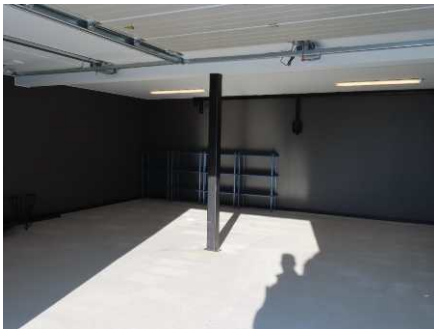
Garasjerommet med bærende søylepunkt i midtpartiet. Søylene bærer midtdrager for bæring av etasjeskille. Gipsplatekledd himling - malte overflater.
