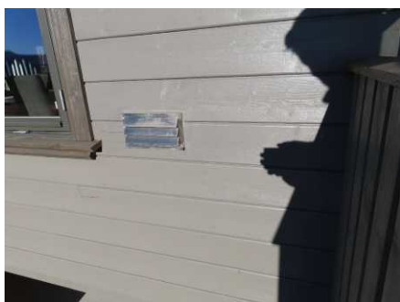
Ventilavkast i vegg for koketopp.
