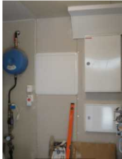
Samleskap for trykksatte rørføringer inne på teknisk rom i kjellerplanet.
