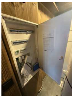
Sikringsskap plassert i teknisk rom.
