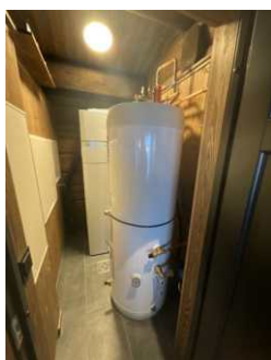
Bereder plassert på teknisk rom.
