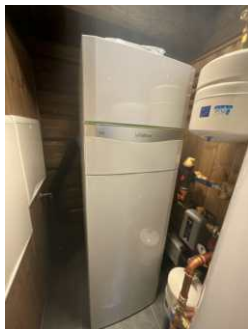
Varmepumpe plassert på teknisk rom.
