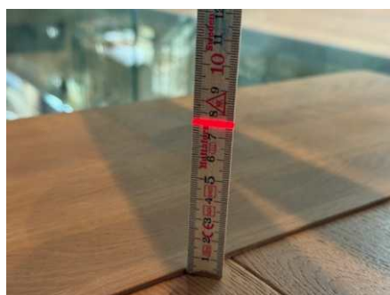
16mm/2m i 2.etasje ved trapp.
