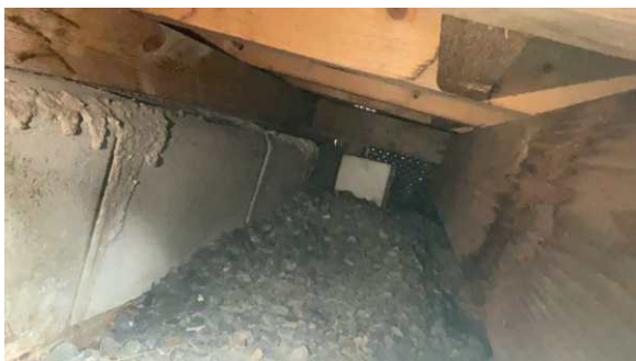
Synlig platon under balkong sør/vest.
