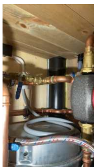
Synlig isopor bak kryssfiner plate på teknisk rom.
