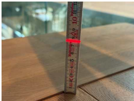
16mm/2m i 2.etasje ved trapp.
