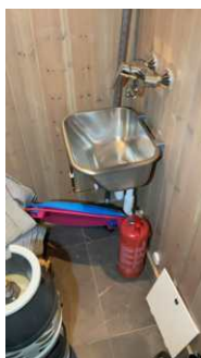
Utslagsvask og avrenning fra skap. Flow-stop på gulv.
