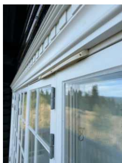
Ødelagt utvendige ventil-rister.
