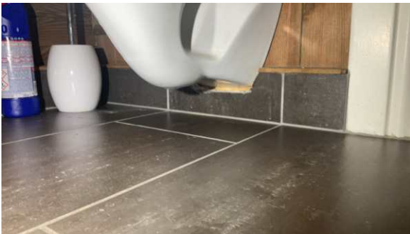
Ingen synlig sikring.
