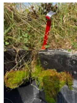
Noe avflassing på torvstokk (ingen råte funnet ved stikkprøver).
