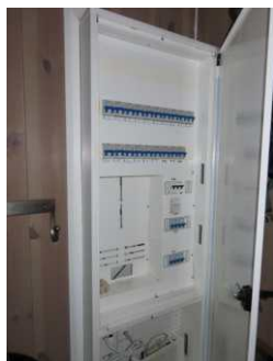
Sikringsskap med 400 volts inntak og jordfeilautomater.
