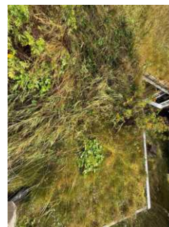
Område med lekkasje over inngangsparti.
