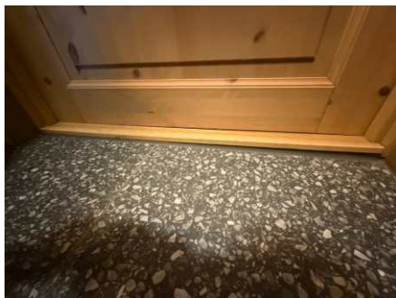
Tett ved dør for tilluft.
