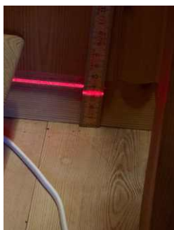
Nullpunkt på laser er 6cm. Avvik er målt til 27 mm på tvers av tv stue.
