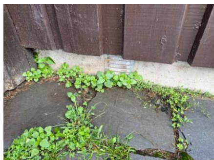
Ventil til krypkjeller.
