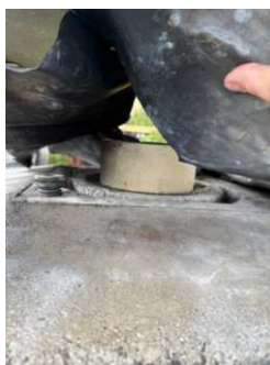
Manglende toppbeslag på pipe.
