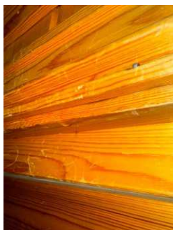
Lekkasje på tekking over inngangsparti på hovedbygningen.
