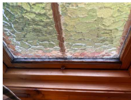
Svertesopp på innsiden av karm.
