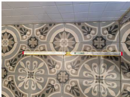
Det er under 1/50 fall fra dusjens nedslagsfelt til sluk.
