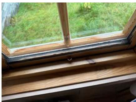
Svertesopp på innsiden av karm.
