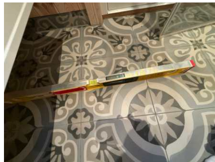
Våtrommet har fall under 1/100 utenfor dusjsone og oppbrett på 15mm kan ikke konstanteres.
