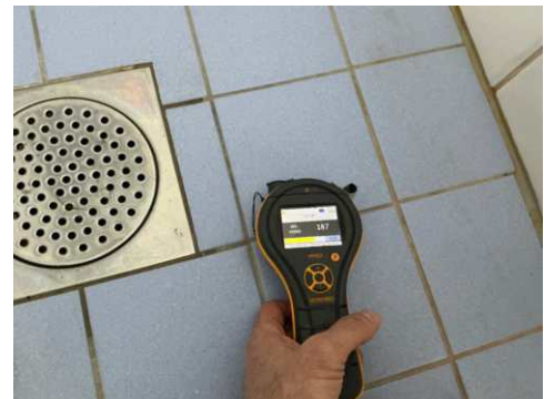
Forhøyede utslag på gulv i dusjsone
