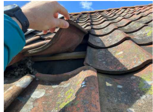
Stikk kontroll undertak. Normal slitasje registrert.
