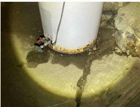
Betydelig rust og slitasje på bereder
