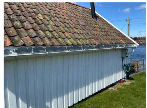
Slitasje og avskalling på takrennebeslag
