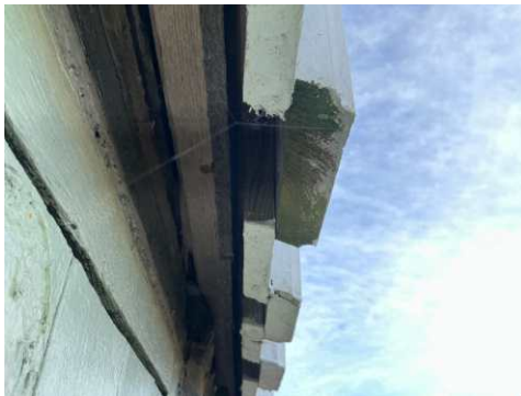
Kledning er utlekket og bakenforliggende asfaltplater
