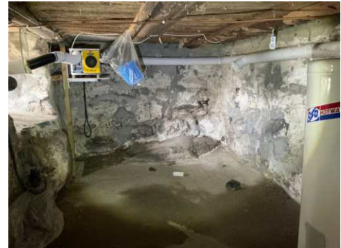
I denne delen er det installert avfukteranlegg ca 2018
