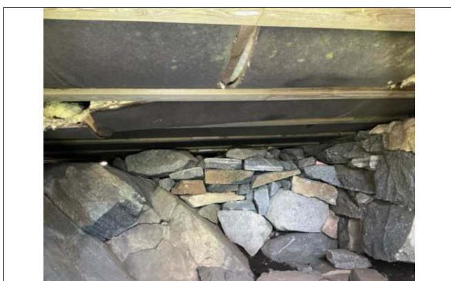
Underside av bjelkelag. Enkelte at asfaltplatene er løsnet og man ser synlig isolasjon. Plater bør festes skikkelig
