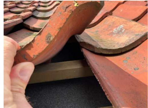
Stikkontroll undertak. Normal slitasje registrert.
