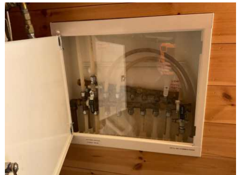
Fordelerskap i uetg garasje.
