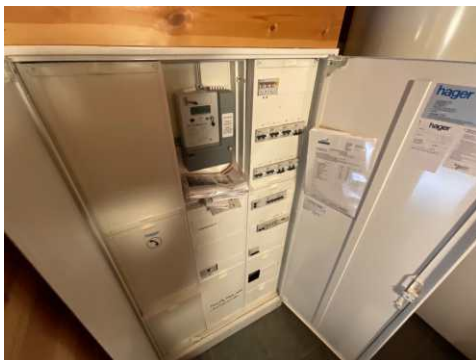
Sikringsskap i garasje
