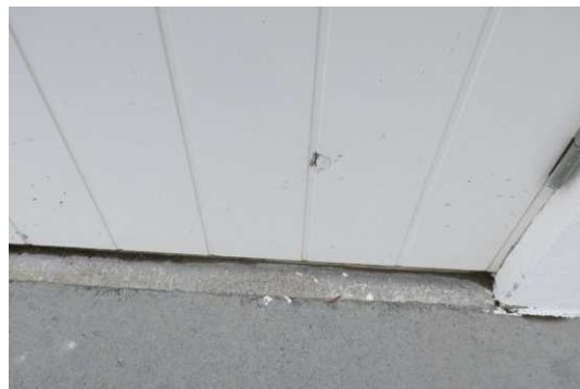
Liten skade på dørblad ytterdør øst.
