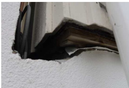
Ufagmessig utførelse i overgang grunnmur/yttervegg på opprinnelig hushjørne nordøst.
