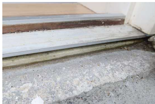
Det bør monteres beslag på åpning mellom ny og gammel terskel.
