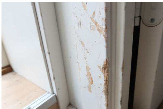
Slitasje på dørkarm ytterdør øst.
