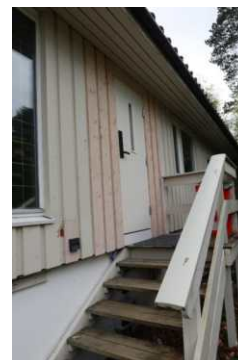
Store lysåpninger på trapp og rekkverk.
