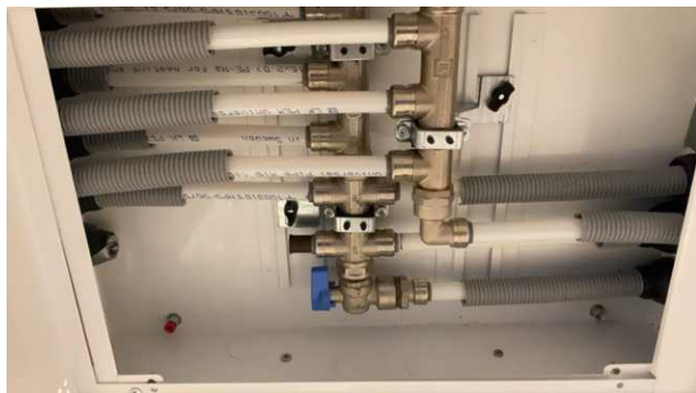
Fordelerskap i himling hybel nr 2.
