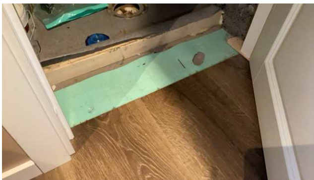
Noe manglende laminatgulv i dørutsparring mellom bod og soverom underetasje.
