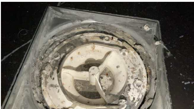
Sluk under servantinnredning.
