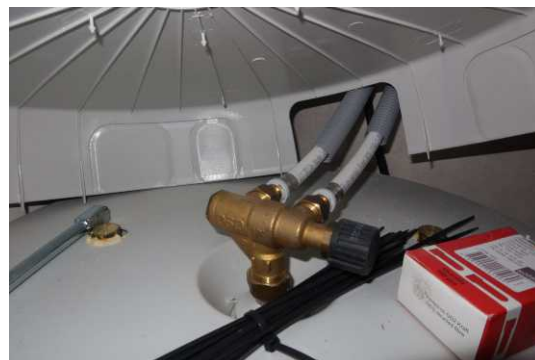
Blandeventil på bereder underetasje hoveddel
