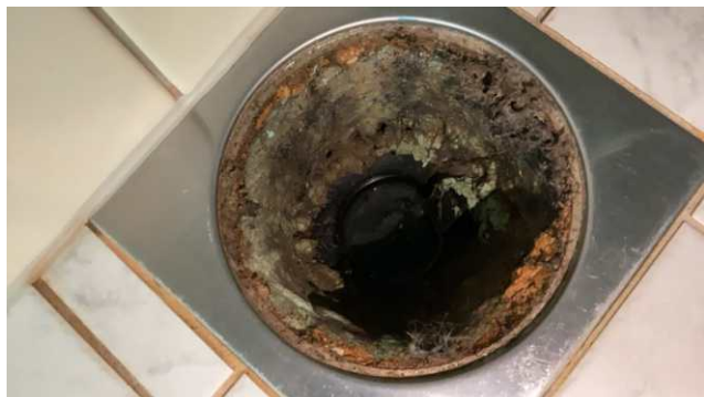
Sluk fra byggeår i dusjhjørnet.
