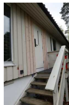
Store lysåpninger på trapp og rekkverk.
