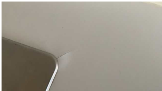
Småskade på benkeplaten.
