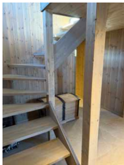
Manglende rekkverk og stor åpning i øverste del av trapp.
