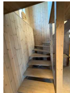
Manglende håndløper på vegg.
