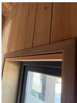
Løs foring på vindu bad 1. etasje.
