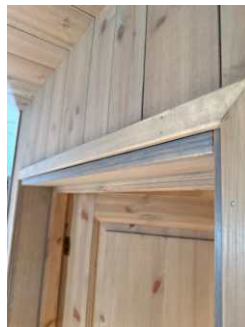
Løs foring på dør til bad underetasje.
