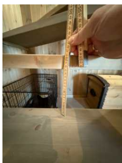
Åpninger på over 10cm mellom trinn.
