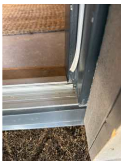
Manglende pakning på ytterdør.
