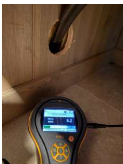
Måling etter fukt i vegg mot terreng.
