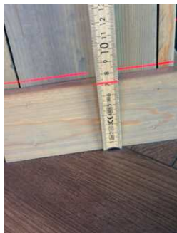
Nullpunkt på laser er 6cm. Avvik er 12mm på tvers av kjøkken/stue.
