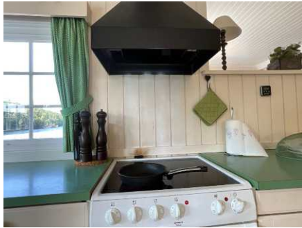
Montert avtrekk over komfyr.
