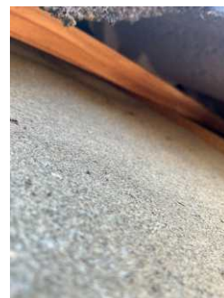
Del av taktekkning. Takstein er flyttet på.
