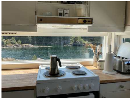
Montert avtrekk over komfyr.
