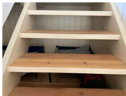
Åpning mellom trinn overstiger 10 cm. Del av trapp.
