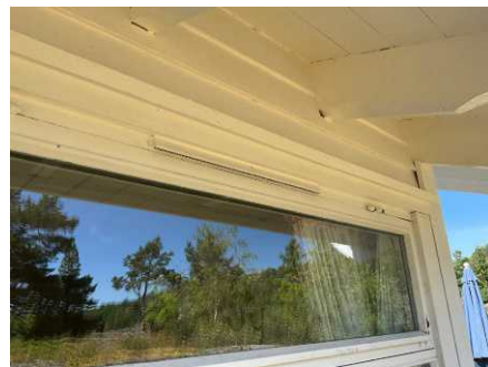
Eksempel på montert ventil i vindu.
