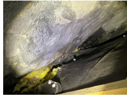
Del av krypkjeller med edderkopp poser.
