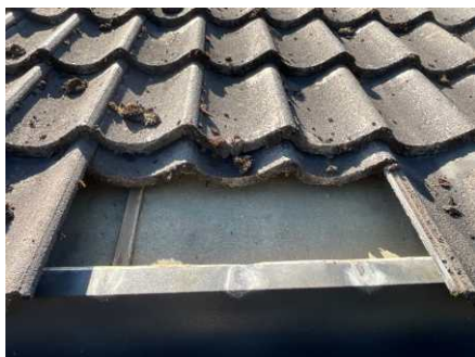
Del av taktekkning. Takstein er flyttet på.
