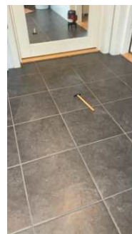
Endel bom/hul-lyder og noe riss i fuger.
