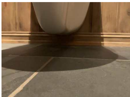
Ingen synlig spalte under toalett.
