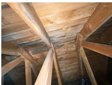
Utsnitt fuktmerker på undertak.
