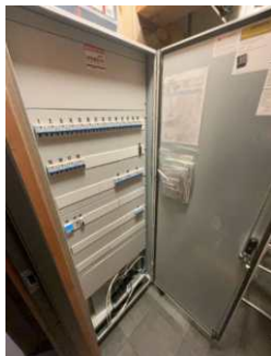
Sikringsskap med automatsikringer.
