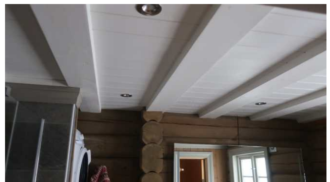
Malt himling med bjelker og downlights i rom med flat himling.
