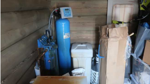
Vannrenseanlegg plassert i bod.
