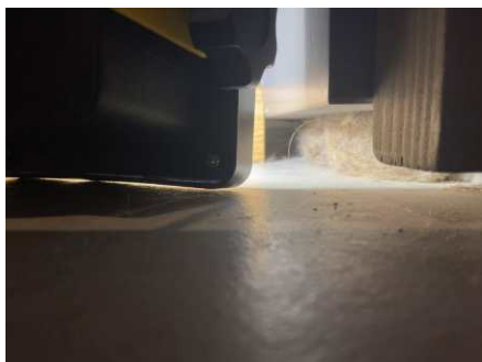
Membran oppbrett ved dør.
