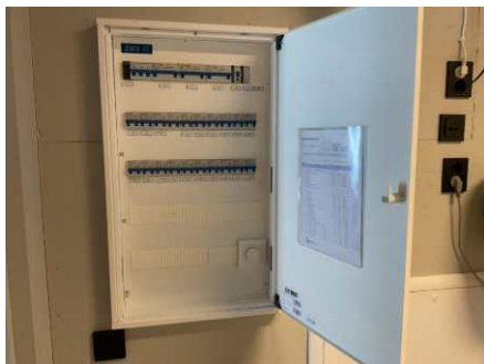
Sikringsskap plassert på teknisk rom.
