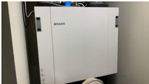
Motor for ventilasjonsanlegget.
