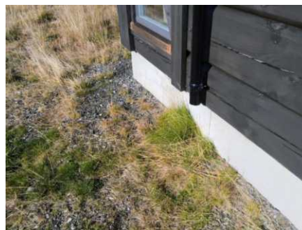
Mangelfull bortledning av takvann.
