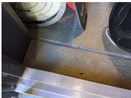
Sprekke i flisfuge i utvendig bod.
