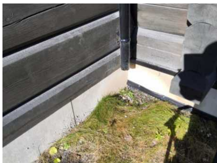
Mangelfull bortledning av takvann.
