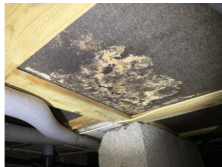
Misfarging på stubbloftsplaten på undersiden av bjelkelaget.
