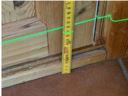
Fallforhold - ca. 107 mm overkant gulv ved terskel
