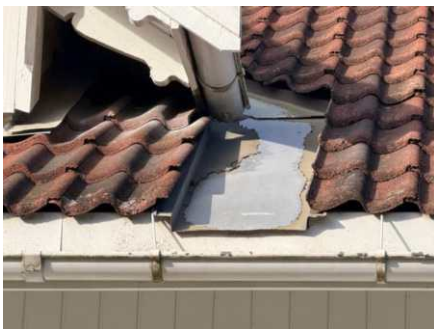
Påvist noe slitasje på beslagene som følge av alder
