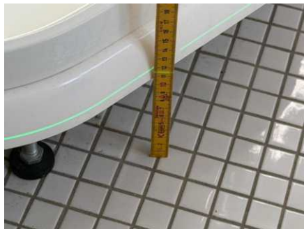
Fallforhold - ca. 115 mm overkant gulv foran dusjkabinett (ved sluk)
