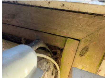
Manglende lufting i nedre kant av kledning mot grunnmur.
