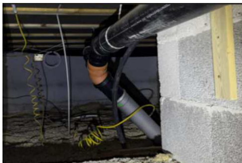
Synlige vann- og avløpsledninger i krypkjeller
