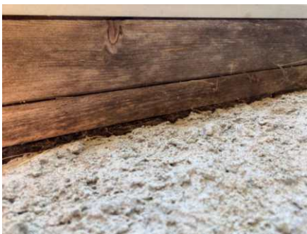
Manglende lufting i nedre kant av kledning mot grunnmur.
