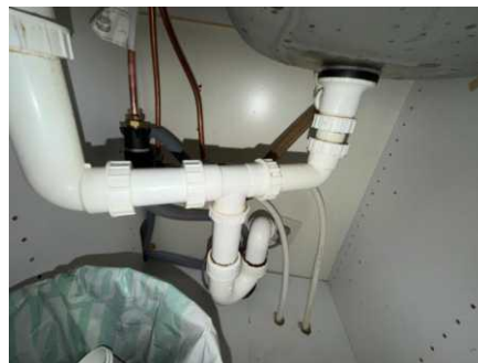
Røranlegg i kjøkken
