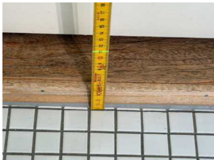
Fallforhold - ca. 110 mm overkant gulv ved terskel
