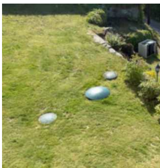
Minirensanlegg er plassert syd for bygningen.
