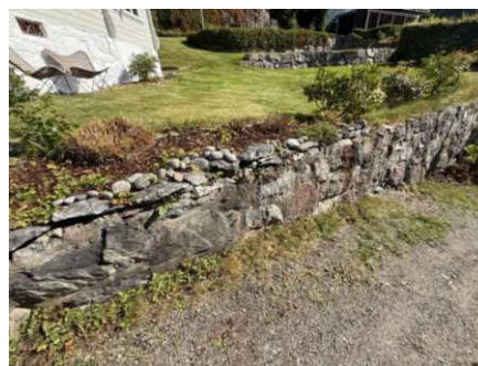
Vedlikeholdsbehov av støttemur ved adkomst må påregnes
