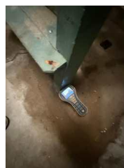
Nedre del av trestige til krypkjeller under stue er mettet med fukt og råte i stige vil utvikle seg.
