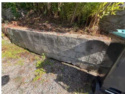
Støttemur ved garasje må påregnes bygges ny.
