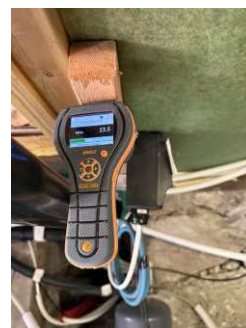
Lave fuktverdier ble målt i krypkjeller tilbygget del.
