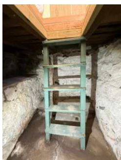
Noe fuktig i krypkjeller under stue.
