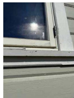
Vinduer har behov for vedlikehold.
