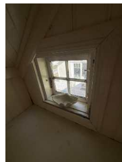
Sprukket glass vindu mot nord soverom loftsetasje.
