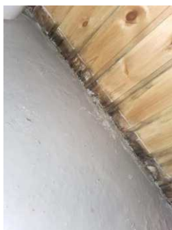
Overflate vegg - Råteskader på trekledning
