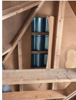
Yttertak og takkonstruksjon - Løse undertaksplater
