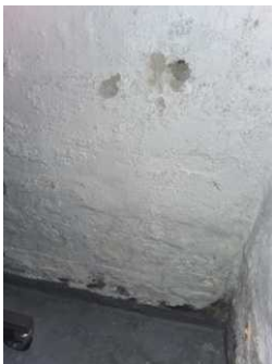
Overflate vegg - Salt/kalkutslag grunnmur
