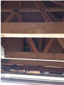
Yttertak og takkonstruksjon - Løse undertaksplater
