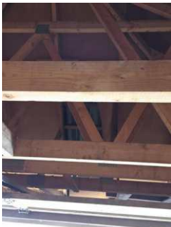
Yttertak og takkonstruksjon - Løse undertaksplater
