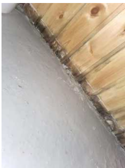
Overflate vegg - Råteskader på trekledning
