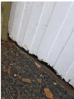
Veggkonstruksjon og fasadematerialer - Råteskader på ytterkledning
