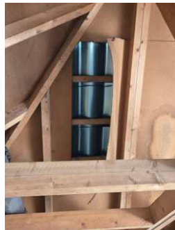
Yttertak og takkonstruksjon - Løse undertaksplater
