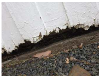
Veggkonstruksjon og fasadematerialer - Råteskader på ytterkledning
