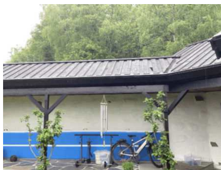
En underligger har flyttet seg.
