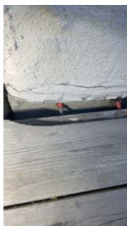
Løsnet innfesting på hjørnet mot nord/vest.
