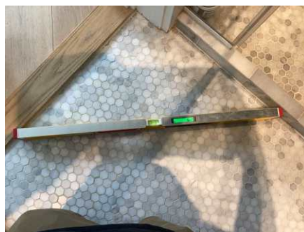
Fall mot spalte 5mm/m.
