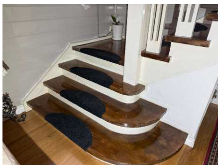
Noe knirk i nedre del av trappen.
