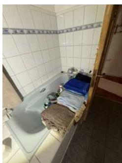
Ingen inspeksjonsluke til innunder badekar.
