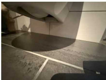
Ingen synlig dreksåpning under vegghengt toalett.
