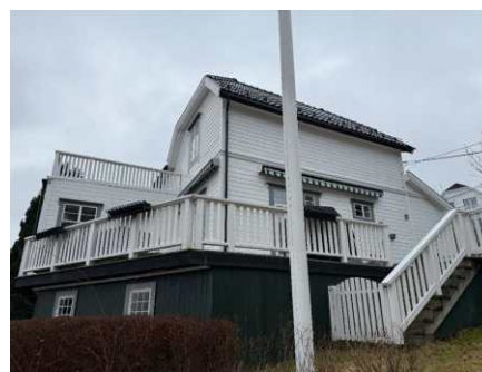
Rekkverkshøyder er under dagens krav på 1m
