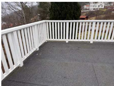
Noe vedlikeholdsbehov av rekkverk.
