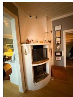
Ildfast plate på gulv anbefales etablert.
