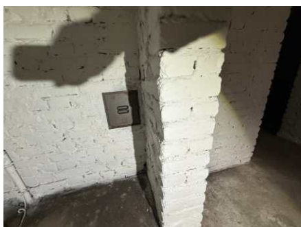
Sotluke er plassert i kjeller.
