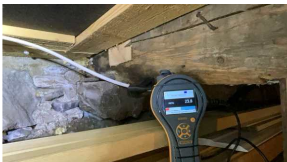
Fuktmåling - Skillekonstruksjon - Høyt trefukttinnhold/vektprosent i konstruksjonens ytterkant.
