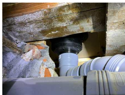
Synlig underside av dusjsluk, under kabinett.
