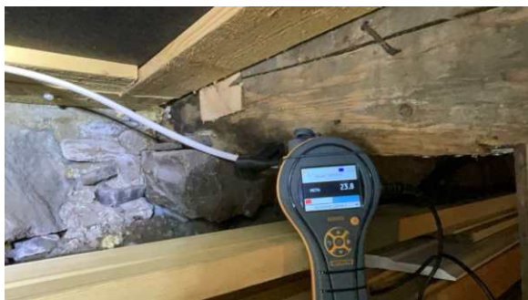
Fuktmåling - Høyt trefukttinnhold i skillekonstruksjonen.
