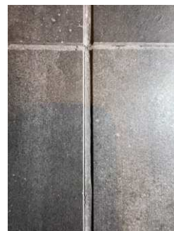
Riss i hardfuger rundt flis med bom/hulldyd
