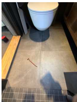
Bom/hulldyd under enkelte fliser.
