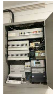
Sikringsskap med automatsikringer.
