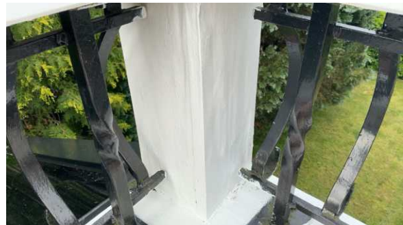
Råte i en rekkverksstolpe.
