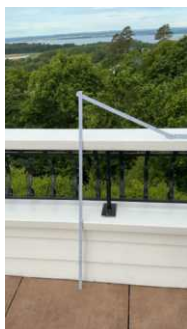
Lavt rekkverk på terrassen. På det laveste er rekkverket 82 cm
