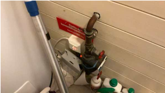
Vannmåler og stoppekran på vaskerommet.
