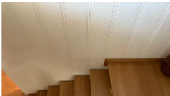
Det mangler håndløper på veggen i trappa.
