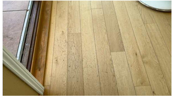
Noe merker i parketten ved utgangen til terrassen i 1 etg.
