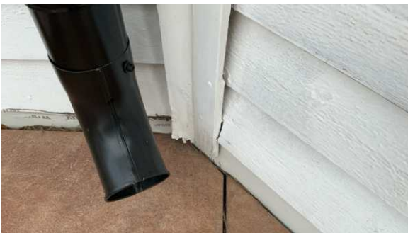
Råte i hjørnekaske på terrassen.
