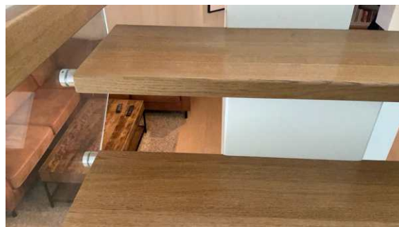
Store åpninger mellom trinnene i innvendig trapp.
