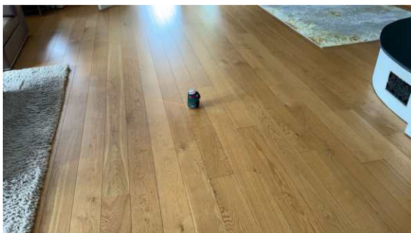
Skjevheter i gulvene er innenfor gitte krav i stuen 1 etg.
