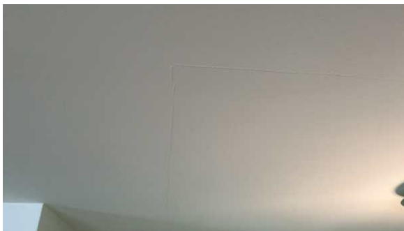
Riss i taket i spisestuen.
