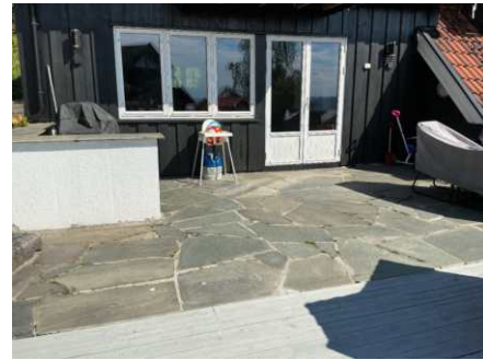
Terrasse på ca. 22 kvm., avvik kan forekomme grunne skrå skjæringer mm. Noe bør sikres.
