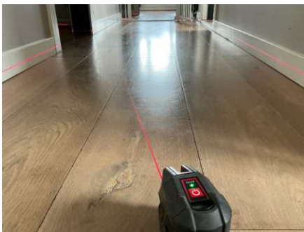
Nivellering trapperom + soverom 2 etasje, avvik ca. 10-20 mm
