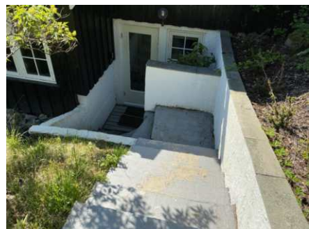
Støpte trapper og repos, sår, sprekker, avflassing av maling. Bom/hullyd under skifer, sprekker i støttemur, avflassing av maling på støttemur. Rekkverk må monteres, tiltak rundt trapp må forventes.
