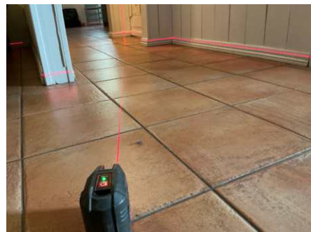
Nivellering kjeller, hybel - ingen avvik registrert
