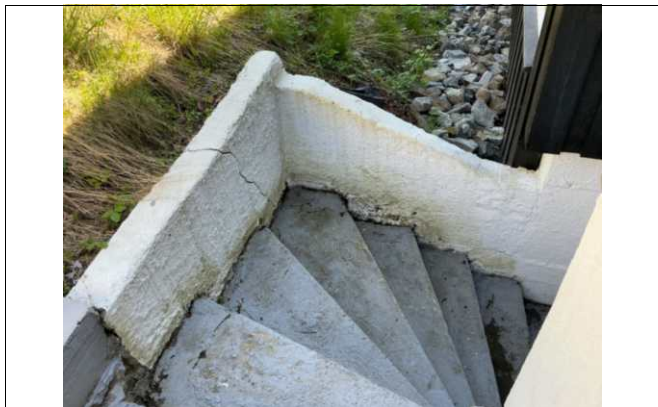
Sprekker og manglende sikring, må utbedres.
