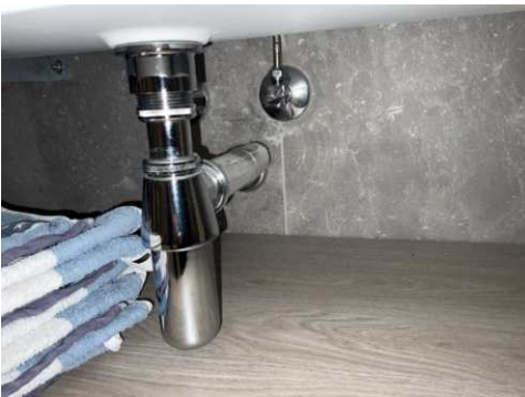
Røropplegg under håndvask, bad, med tilkomst fra soverom.
