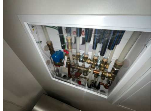
Plastrør (rør-i-rør). Rørskap innfelt i vegg på vaskerom.
