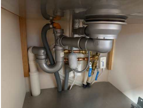
Røropplegg under kjøkkenskiv.
