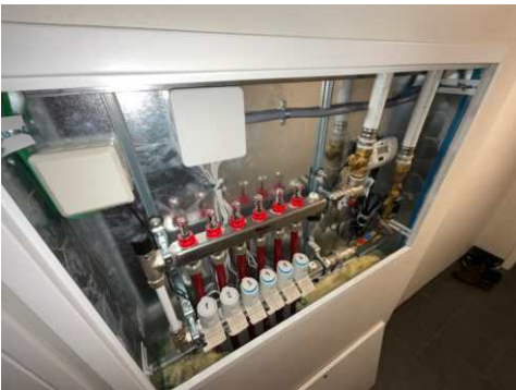
Vannbåren varme. Rørskap innfelt i vegg på vaskerom.
