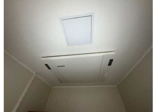
Aggregat for balansert ventilasjon i himling, vaskerom.
