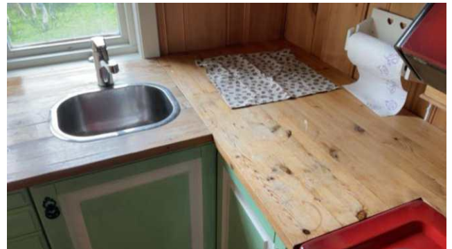
Slitasje på benkeplater
