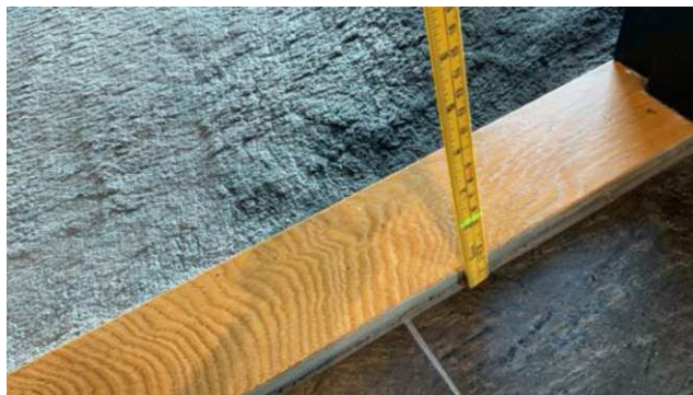
Fall kontrollert med laser. Målt høyde på 5,3 cm ved terskel
