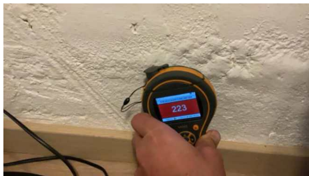
Ved overflatesøk med fuktmåler var det fuktutslag på yttermur og gulv mot grunn
