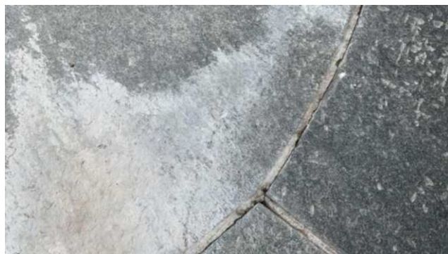
Sprekkdannelse i fuger
