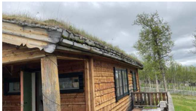
Skjevheter i takkonstruksjonen
