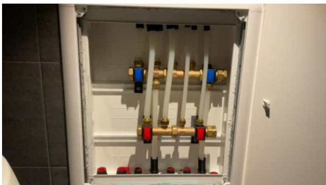
Fordelerskap teknisk rom i tilbygg
