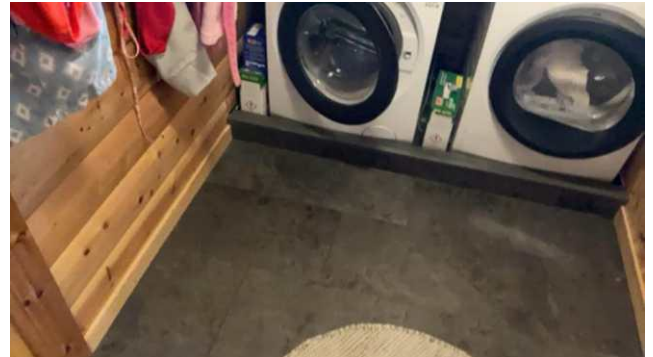
Konstruksjoner tåler ikke fuktbelastning ved vannsøl/lekkasjer
