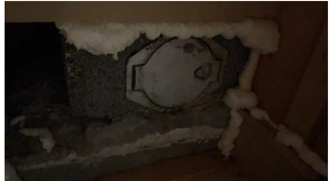
Brennbart materiale er for nært
