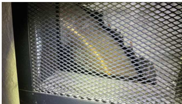
Type røykrør og utførelse bør undersøkes
