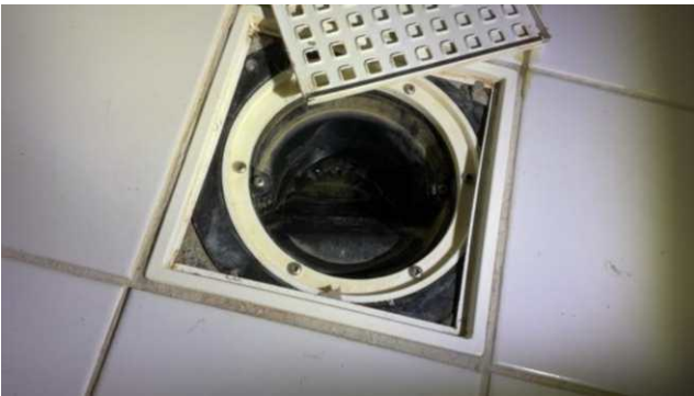
Fra sluk er det ikke tette overgang gulv og trolig mangler på baderom i sin helhet
