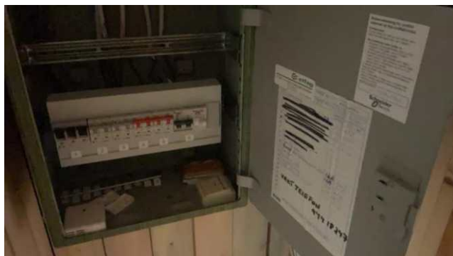
Sikringsskap, kursfortegnelse bør oppdateres
