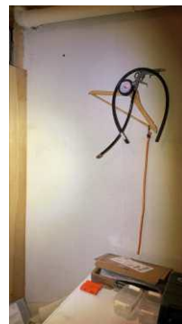
Bemerket sorekk i mur fra bod i kjeller
