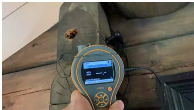
Råte i loft i spisestue, opplyst om tidligere lekkasje før renovering og ikke siden tiltak ble foretatt
