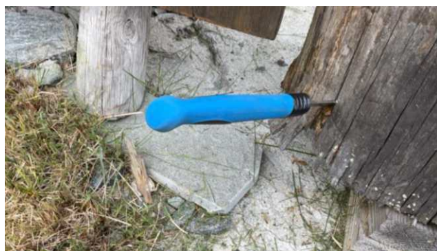
Råte i søyle
