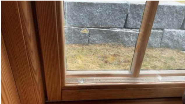
Sprekk i glass
