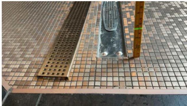
Målt på 7,1cm ved sluk, høydeforskjell på 1,8 cm
