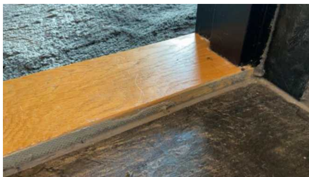
Synlig oppbrett mot terskel, men ikke over hele
