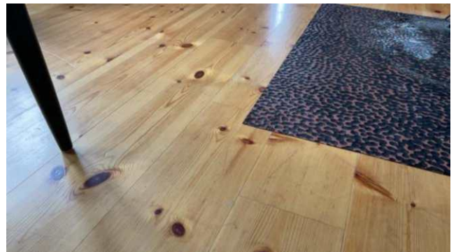
Slitasje på gulvoverflate
