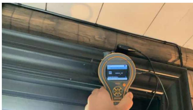
Det er rennmerke i spisestuedel, tidligere kondens som er utbedret, ved fuktmåletaking var det ikke fuktutslag
