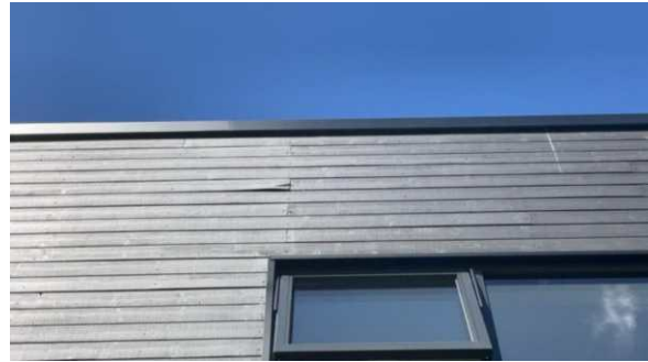
Noen deformerte panelbord som bør skiftes.
