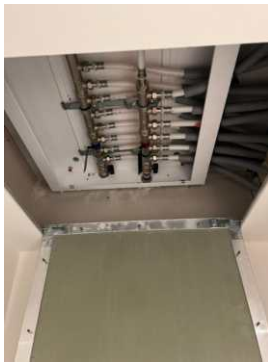
Rør i rørskap montert i himling på vaskerom
