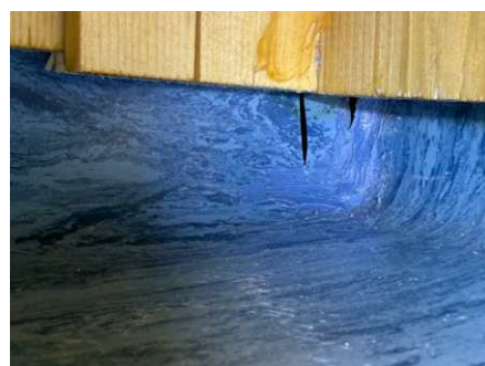
Sprekk i vinylbelegg.
