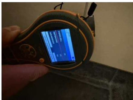
Fuktsøk i dusjonen.
