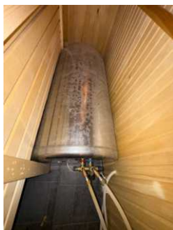
Varmtvannstank på badstu fra 2008.
