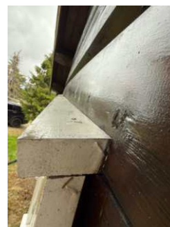
Ukjent løsning for tetting over vinduer.
