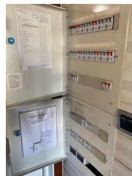
Sikringsskap med kursfortegnelse
