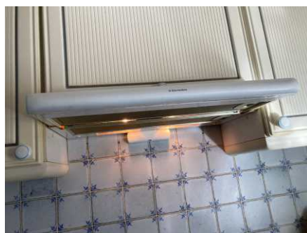
Avtrekksvifte på kjøkken.
