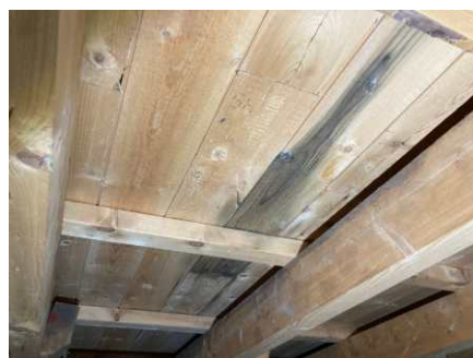
Stedvise fuktskjolder i undertaket.
