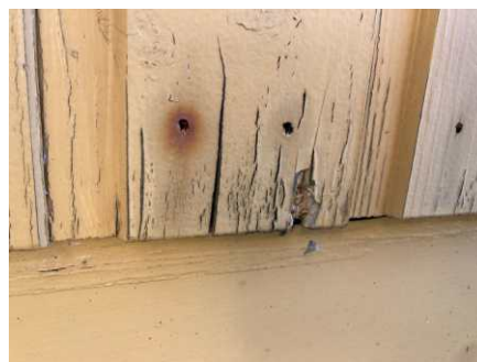
Råte i bunn av boddøren.
