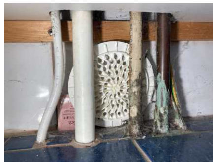
Mangelfull/feil utførelse rundt rørgjennomføringer som gir fare for fukt i konstruksjonen i våtsone under servant.
