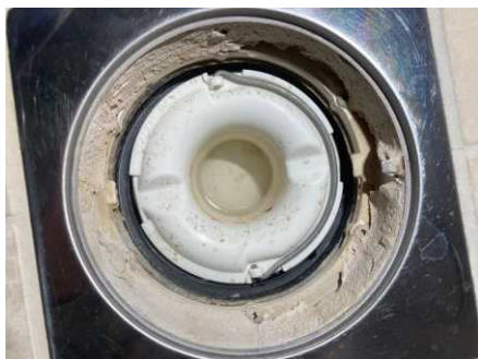
Plastsluk i dusjsonen.
