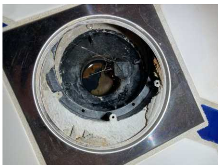
Plastsluk i dusjsonen.
