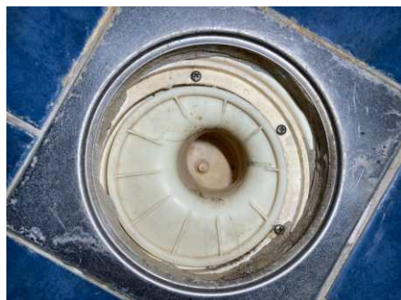
Plastsluk i dusjsonen.
