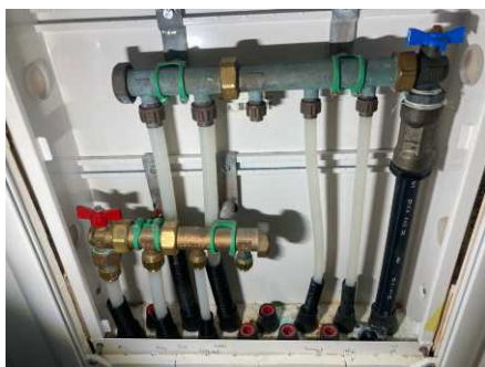
Fordelerskap for rør.
