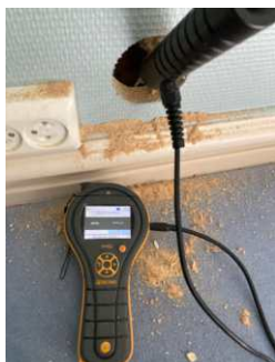
Fuktmåling i vegg mot våtsone dusj fra tilstøtende soverom.
