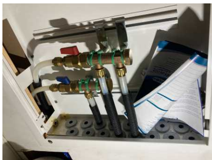
Fordelerskap for rør.
