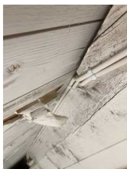
Malingflass og misfarging i undertak og på sperrer.
