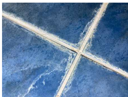
Slitasje, misfarging og riss i flisfuger
