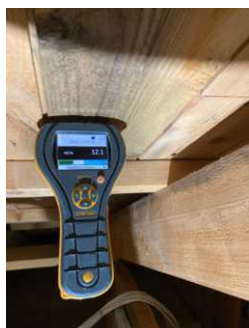
Fuktmåling i område med fuktskjolder.
