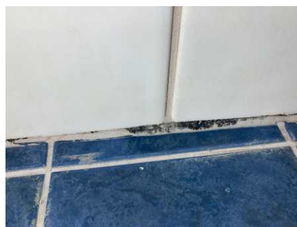
Sprekker og svertesopp i elastisk fuge
