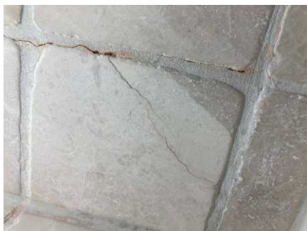
Sprukket flis og sprekker i flisfuger
